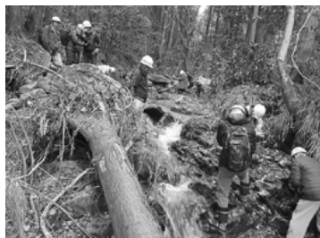
被害状況を確認中
