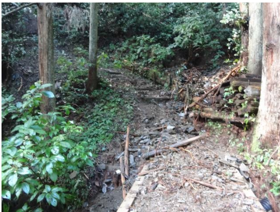
感性トレイル：木橋入口崩落
