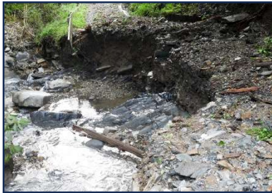
トンネル-橋間道路流出
