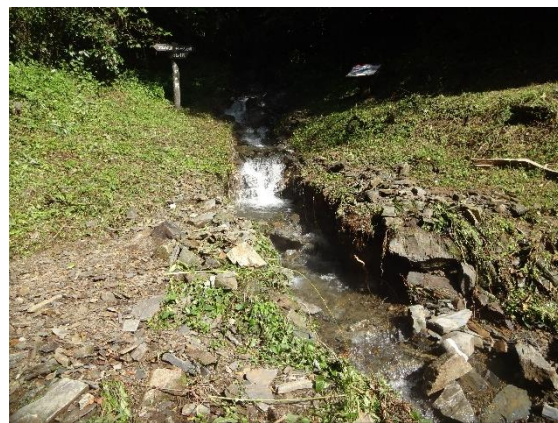
杉の沢：川底流掘削流出
